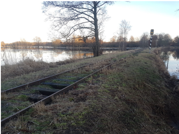
"Stemmer Seenplatte" am defekten Grabendurchlass.
